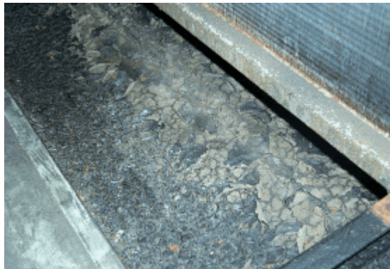
Bateries amb corrosió i brutícia
