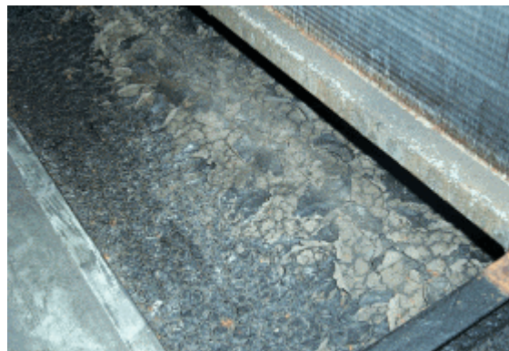
Baterías con corrosión y suciedad
