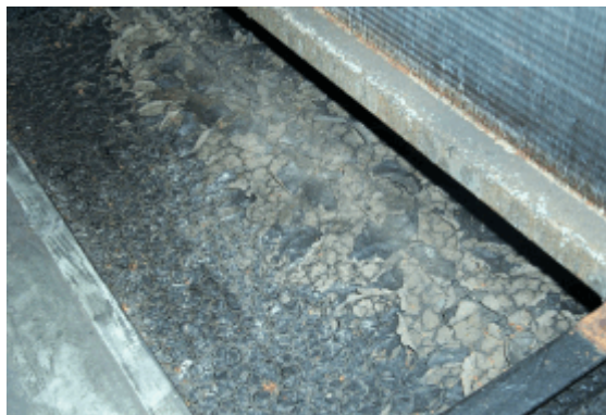
Baterías con corrosión y suciedad
